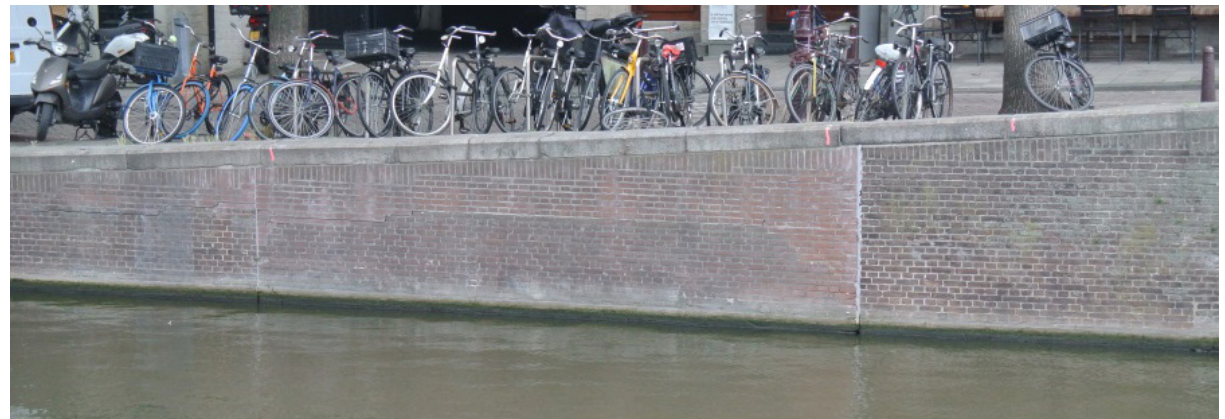
Figuur 10 - Herengracht, metselwerk kade hersteld met een té rode steen. Verder zijn er (voor het beeld) onwenselijk veel dilataties toegepast (Foto MenA, 2019)
