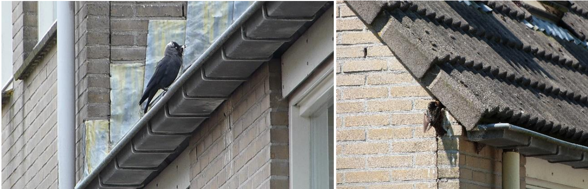
Foto 24 en 25. Rond de Gerardus van der Groeplaan in Twiske-Oost, broeden gierzwaluwen, maar ook huismussen, spreeuwen en kauwen, in een nestplaats onder de randpannen. De invliegopening is langs de muur, onder de dakgoot. Daar zijn ook gemakkelijk poepsoren te zien van de verschillende soorten. De kauwen vliegen boven de goot in.
