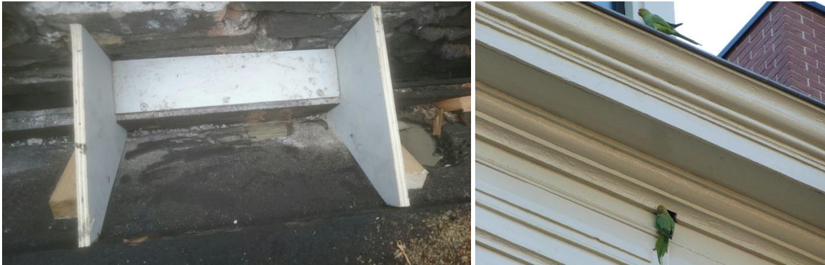
Foto 11 en 12. In de gootbekistingen van Conradstraat 42 t/m 58 broedden vóór de renovatie (2015-16) 6 à 8 broedparen gierzwaluwen, in 2017 nog 2 broedparen. Bij de renovatie zijn hokjes afgetimmerd in de bekisting en invliegopeningen voor gierzwaluwen gemaakt. Halsbandparkieten proberen deze invliegopening te vergroten, zodat ze er ook in kunnen (foto rechts).
