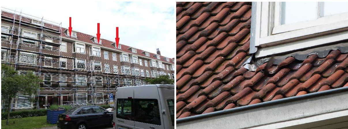
Foto 14 en 15. In de Ring 20-40 zijn veel daken aan renovatie toe. Ook bij gewoon onderhoud worden gierzwaluwnesten vaak geblokkeerd door steigers. In dit geval werd door een bewoner een steiger gemeld, die nesten met jongen blokkeerde. De schilder werd via melding bij RVO gedwongen de steiger naar beneden te halen bij de gierzwaluwnesten. Vooraf-kennis van deze nestplaatsen kan dit soort problemen gemakkelijk voorkomen (Van Walbeekstraat, 22 juni 2015). Foto 15. Uitvliegende gierzwaluw na voeren, bij dakkapel in de Van Walbeekstraat, 20 juli 2015).
