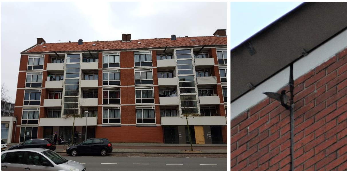
Foto 33 en 34. Rondom de Postjesweg broeden gierzwaluwen in de dilatatievoegen van jaren 50 flats.
