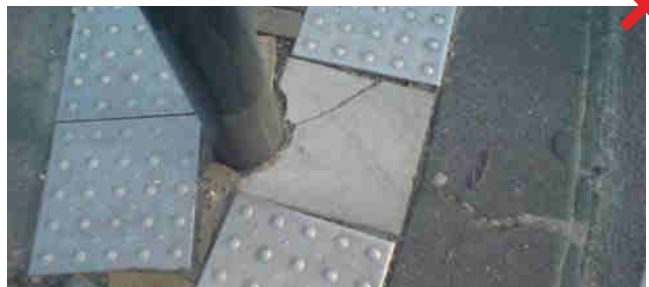
Op vluchtheuvels komen materialen en meubilair vaak samen. Juist daar moet goed ontworpen, ook om beheerproblemen te voorkomen.
