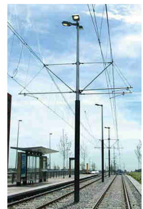
NPK-mast en -armatuur
